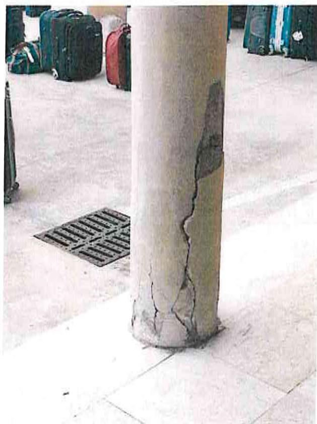
Particolare base pilastrino esterno.
